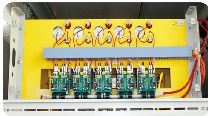
高压 TSC 晶闸管阀组
